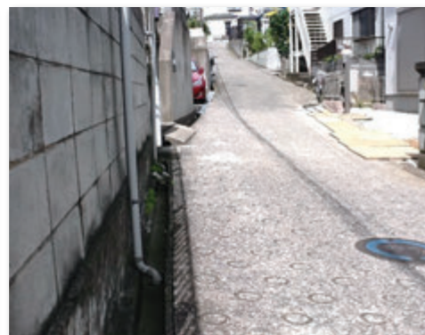
道路側溝の老朽化が激しい大蔵寺町
